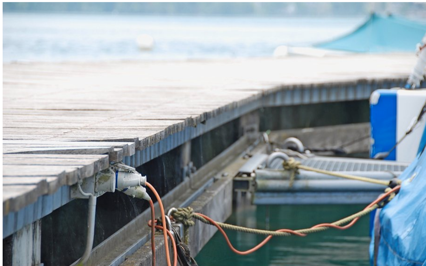
Fast jeder Bootshafen verfügt über Stromanschlüsse: In den allermeisten Fällen sind die Steckdosen mit Fehlerstrom-Schutzschaltern gesichert. Marc Imboden
